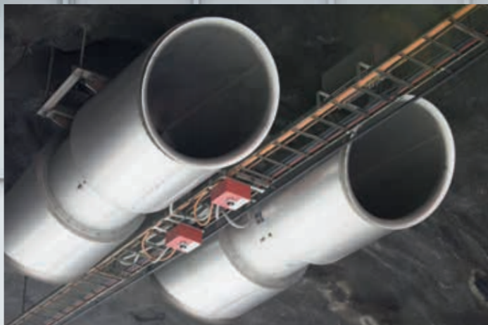
Tunnellüftung Tunnel Ventilation
